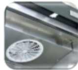
Sistema de aire forzado
