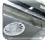
Sistema de aire forzado
